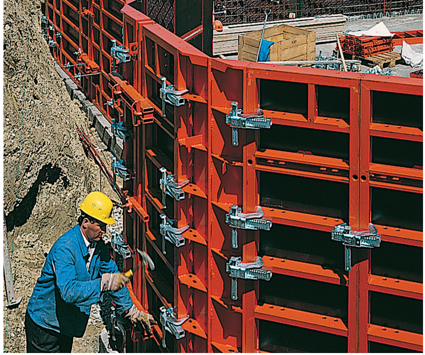
Güvenli çalışma koşullarının sağlanması için konsol ve platformları mevcuttur.
